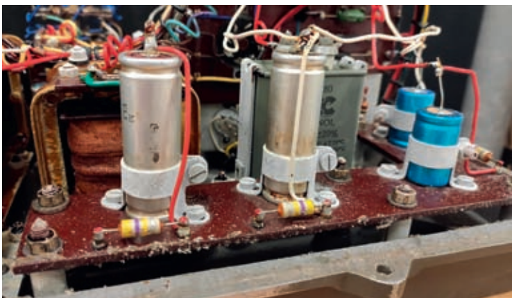
[F. 12] Detalle del estado inicial de los componentes electrónicos.
