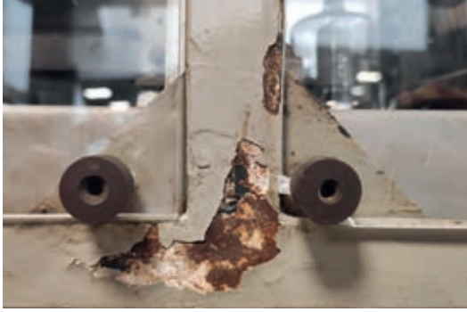
[F. 05] Detalle de pérdidas en el lacado y oxidación en la estructura metálica exterior de la emisora de radio de Ontinyent.
